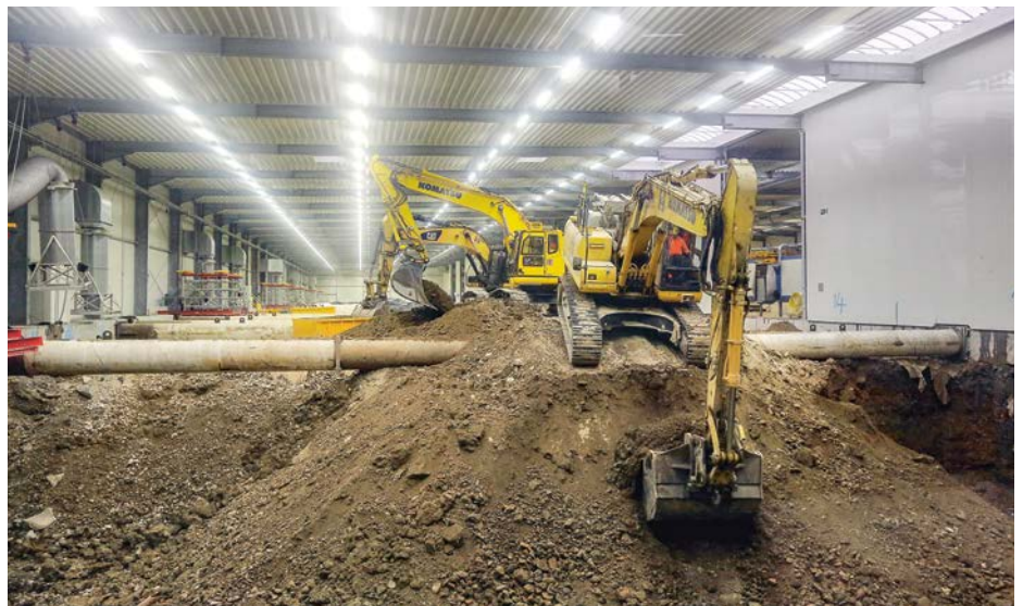
Am 14. Januar 2019 erfolgte der Startschuss für die Aushubarbeiten im Baufeld Süd; Quelle: Pressefoto Roche.
