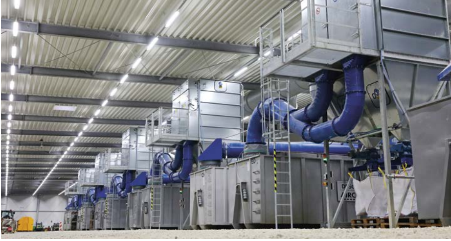
Die Installation der Abluftreinigungsanlage im Baufeld Nord konnte bis Ende Dezember abgeschlossen werden; Quelle: Pressefoto Roche.
