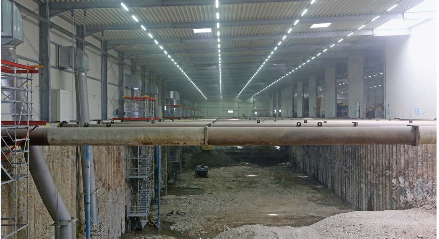
Insgesamt wurden 93.000 Tonnen Erdmaterial aus dem Baufeld Süd ausgehoben und fach- und umweltgerecht entsorgt; Quelle: Pressefoto Roche.
